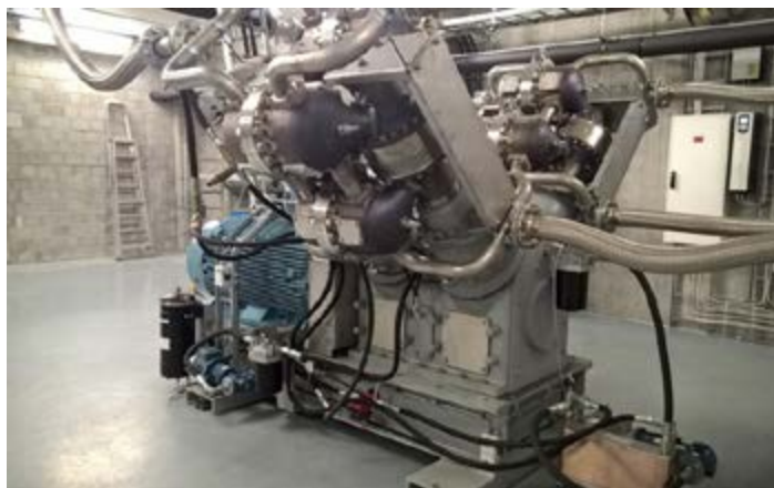
Slika 4: Ena prvih vgradenj TČ SPP 4-160 HL, Lerum, Sogndal. Trenutno poteka vgradnja še ene TČ.
